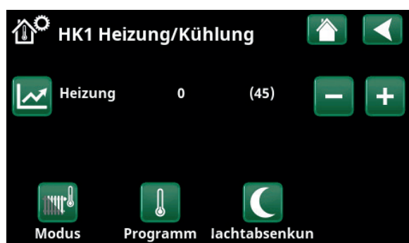
Menü „Fachmann/Setup/Heizkreis/Heizkreis 1“. Der Heizkreis enthält keinen Raumtemperaturfühler, der Sollwert wird in Klammern angezeigt (Vorlauftemperatur 45 °C). Links neben dem Sollwert ist die Außentemperatur (0 °C) für die aktuelle Vorlauftemperatur angegeben.
